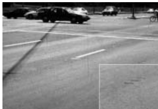
Photo 2-3 : Ressuage et orniérage de faible importance du béton bitumineux d'une chaussée composite
